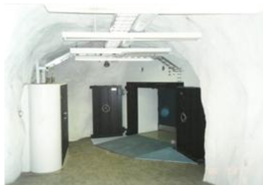
写真-5 シェルター内の遮蔽扉
